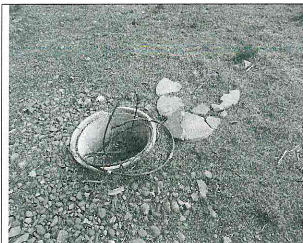
Fig.2 Cámara eléctrica existente.
