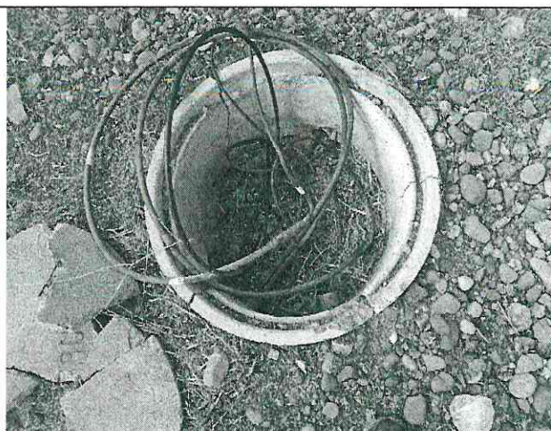
Fig.3 Cámara eléctrica existente.
