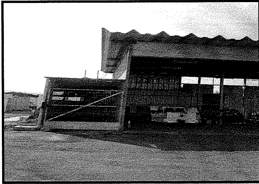
Ilustración 2: Foto donde se muestra construcción anexa al excuartel SSEI, que se debe demoler.
