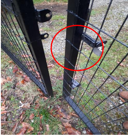
Foto N° 1: Portón de acceso al aeródromo de Cochamó, que pese a contar con candado, es posible su apertura.
