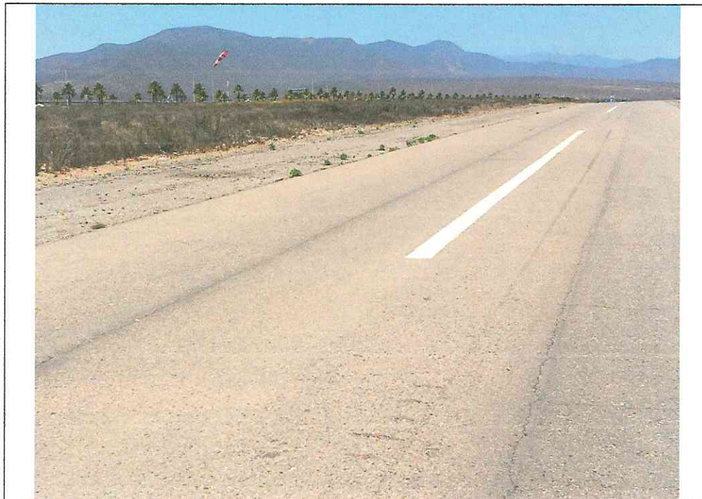
2. Vista de detalle de las marcas dejadas por la hélice del avión.
