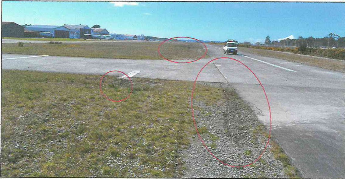
FOTOGRAFÍA 07 Huellas dejadas por el tren de aterrizaje sobre la franja de pista 01.
