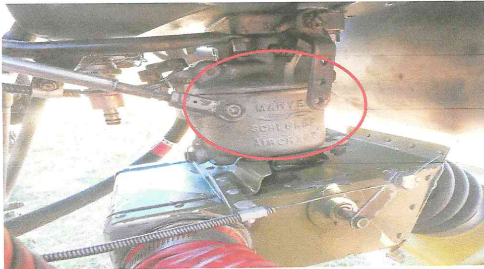
FOTO N° 2 Desconexión entre el mando del acelerador y el carburador
