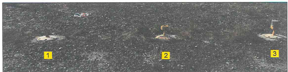
Imagen N°03, luces del umbral de pista 21, dañadas.
