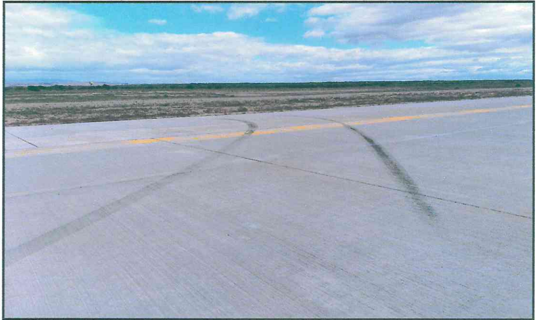
Fotografía 2: Huellas de las ruedas del tren de aterrizaje.
