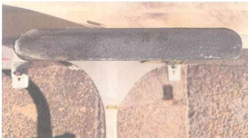
Fotografía N° 5: Detalle de la fractura.
