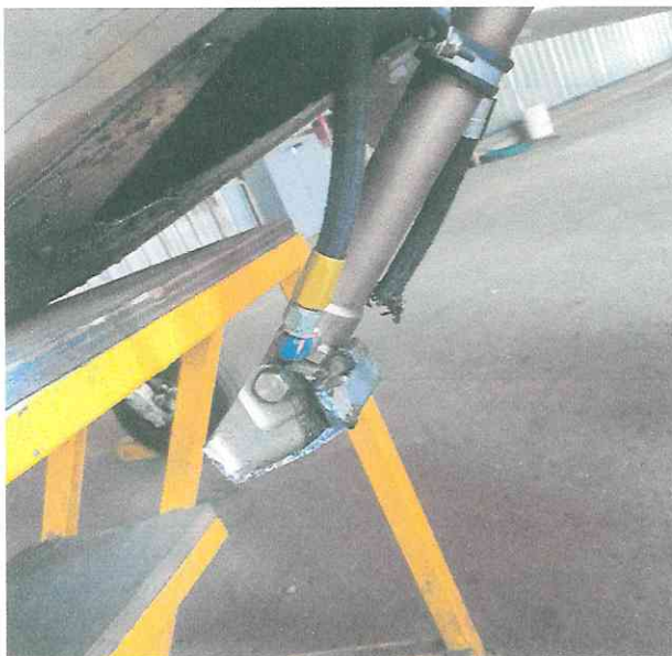
Fotografía N°3: Vista de parte del soporte (fitting).
