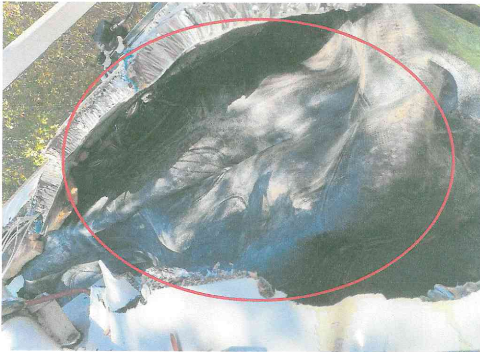
Fotografía 8: Estanque de combustible.
