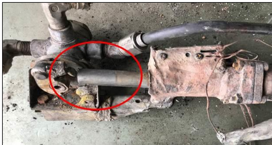
Fotografía 11: Actuador eléctrico y válvula selectora del estanque de combustible de la punta de ala izquierda.
