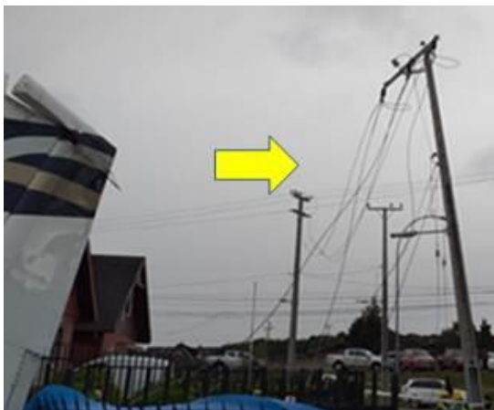
Fotografía 6. Cables del tendido eléctrico, cortados.
