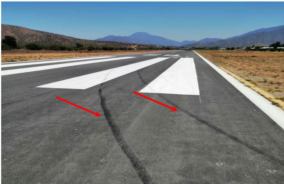
Fotografía 2: Marcas de neumáticos y salida de pista
