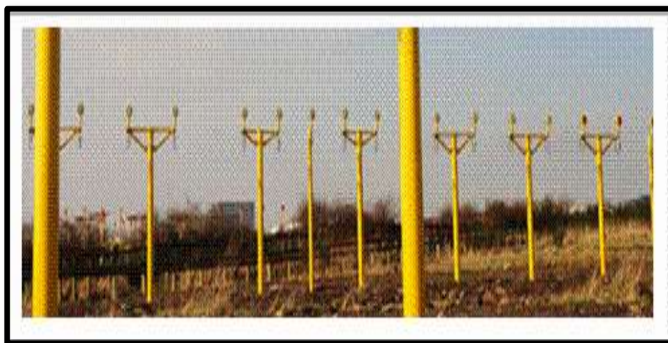
Figura ADJB-1. Mástiles para luces de aproximación
