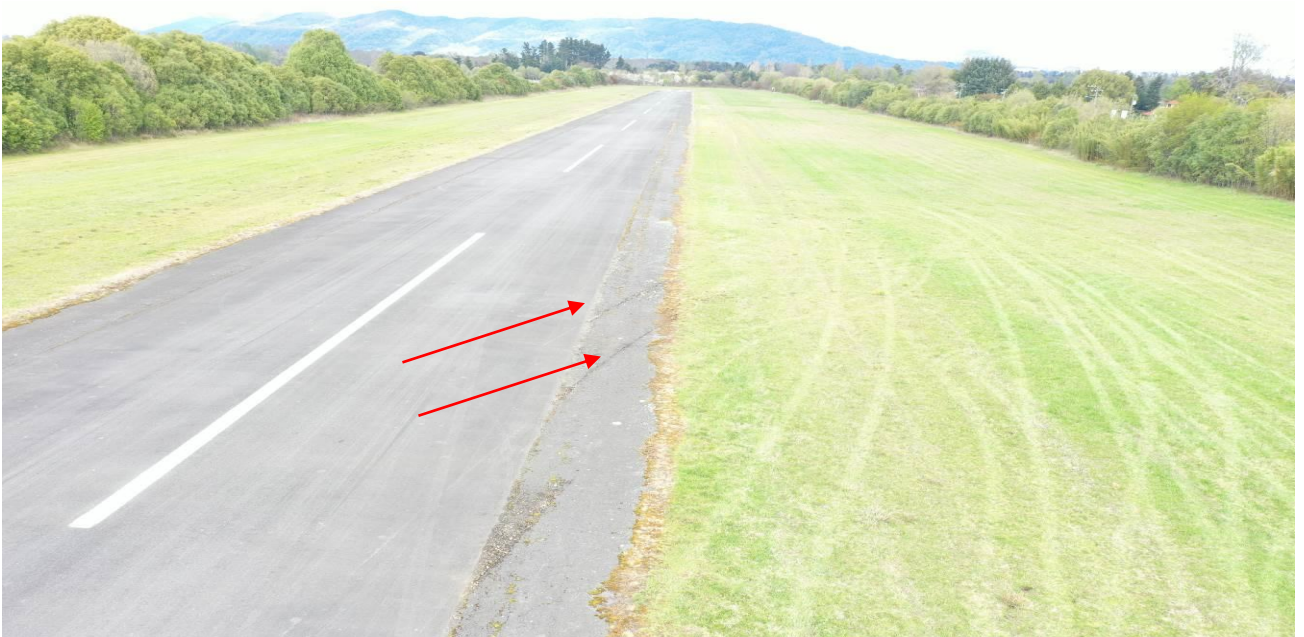
Fotografía 6: Marcas salida de pista
