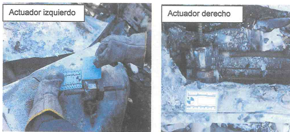
Fotografía N° 7 y 8. Actuadores electromecánicos.
