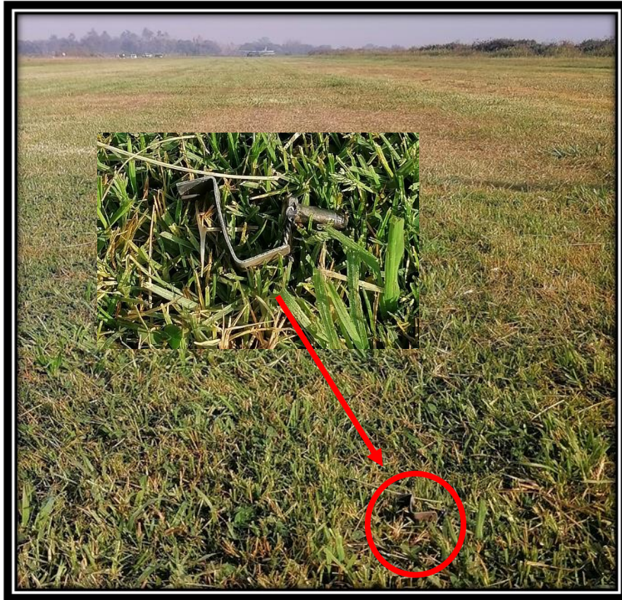
Fotografía N° 1: Perno lado izquierdo desprendido en la pista
