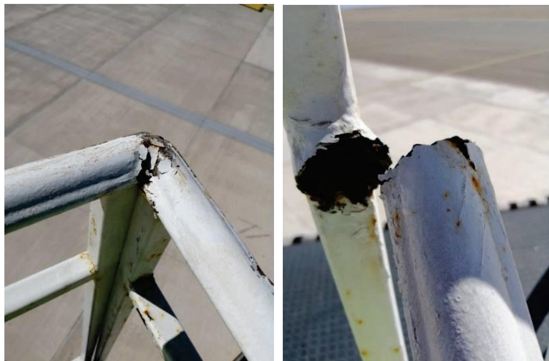
Fotografías N° 3 y 4: Vista de daños en parte superior de escalera.
