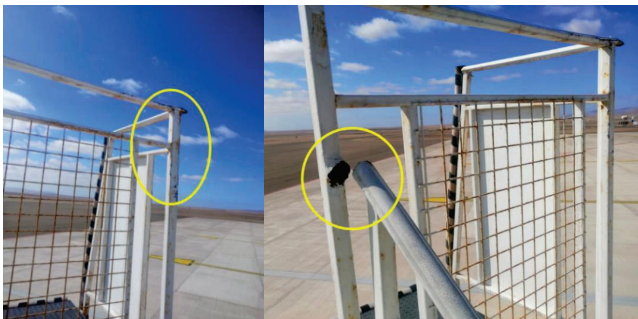
Fotografías N° 9 y 10: Vista de los daños en parte superior de la escalera.
