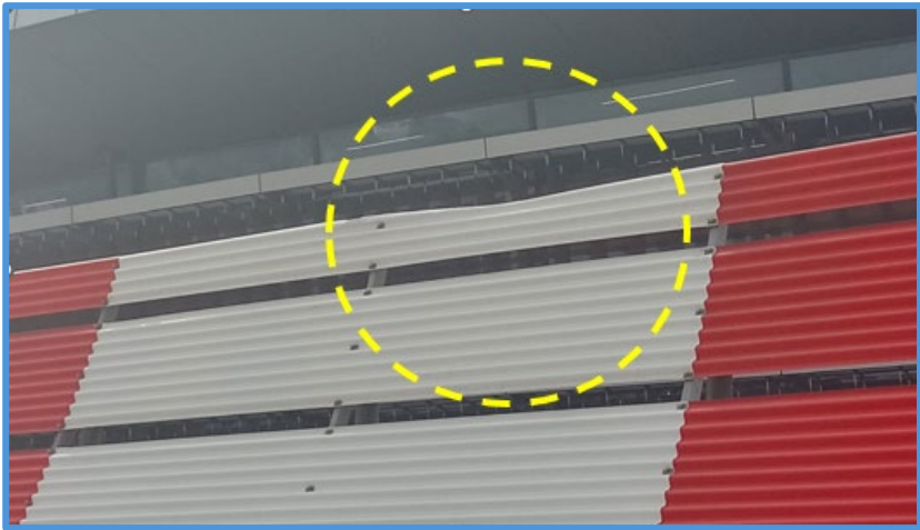
Fotografía N° 5: Vista ampliada del daño por deformación de la barrera difusora, Jet Blast, en círculo amarillo.
