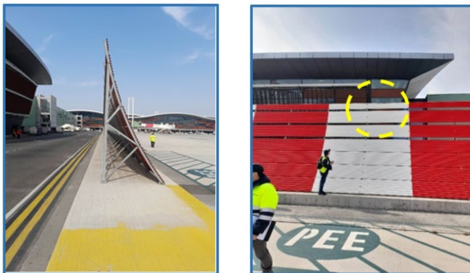
Fotografías N° 3 y 4 Vistas de la barrera difusora, Jet Blast y daño en círculo amarillo.
