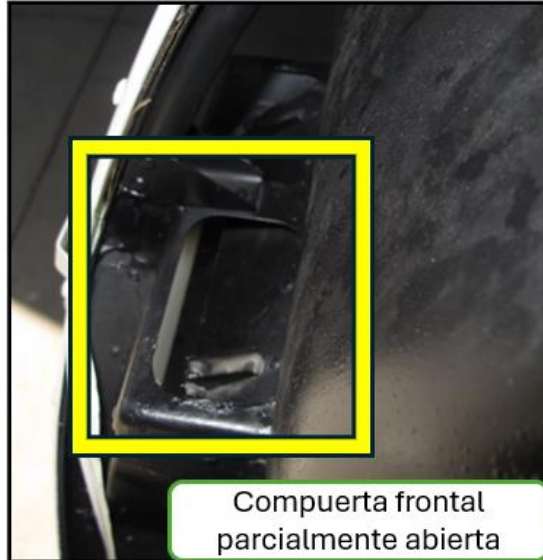
Fotografía N° 20. Compuerta frontal de ingreso aire a cabina, parcialmente abierta.
