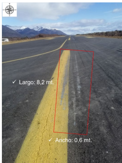
Fotografía N°5: Vista de la marca del Tail strike en la superficie de la pista (cuadro rojo).
