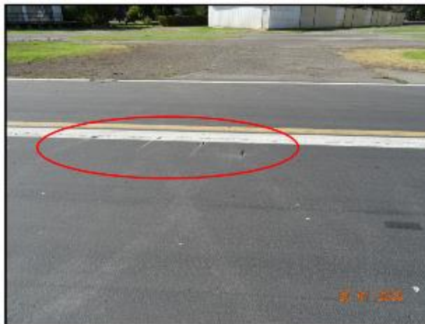
Imagen N°10: Marcas de hélice en la superficie de la pista 26.
