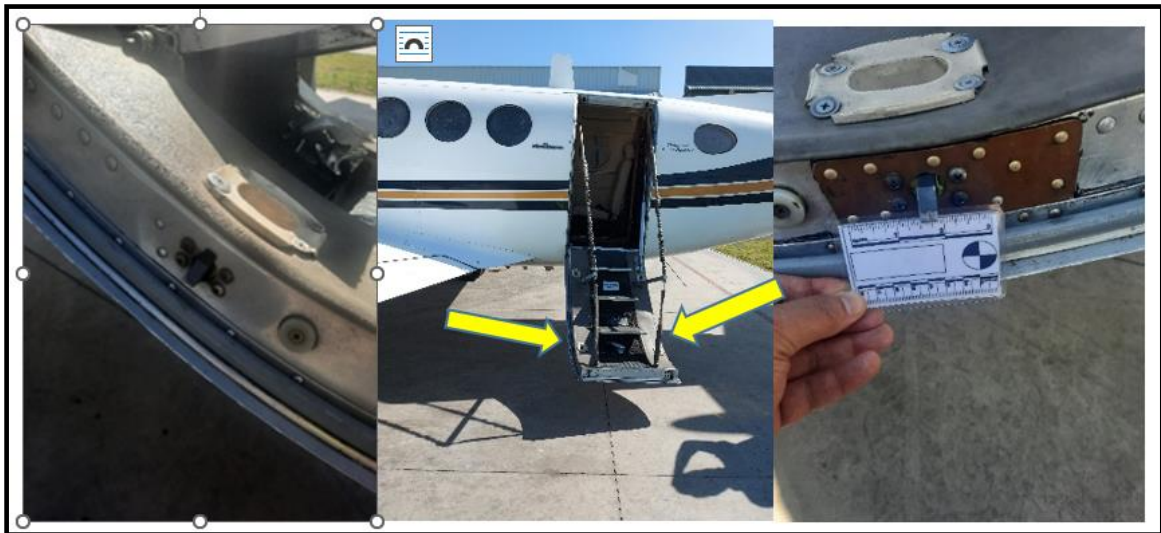
Fotografía N° 3: Vista de la puerta de acceso a cabina y zona reparada el día 02 de septiembre de 2022.
