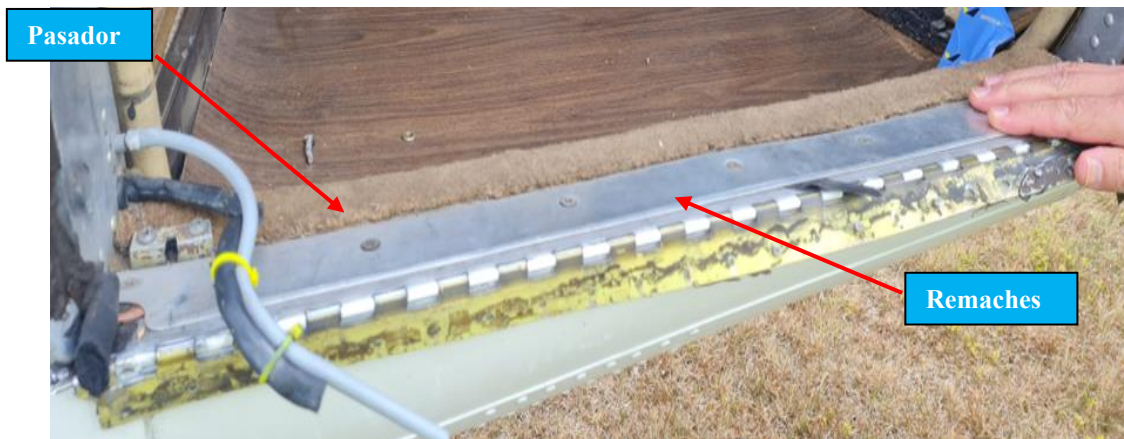
Fotografía N° 4: Bisagra inferior puerta de acceso.
