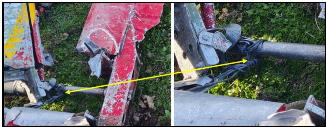
Fotografías N°24 y 25: Vista del estabilizador horizontal y cables de control.
