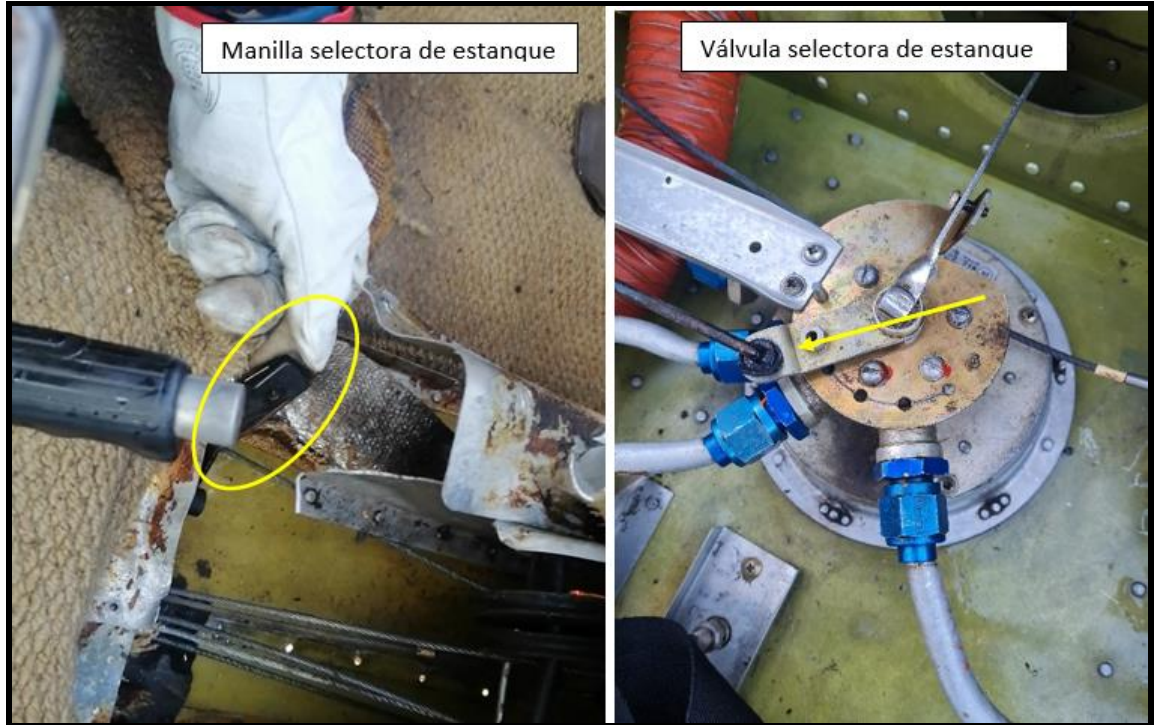
Fotografías N°30 y 31: Manilla selectora (círculo amarillo) y válvula selectora de estanque de combustible (flecha amarilla), en posición punta de ala izquierda.
