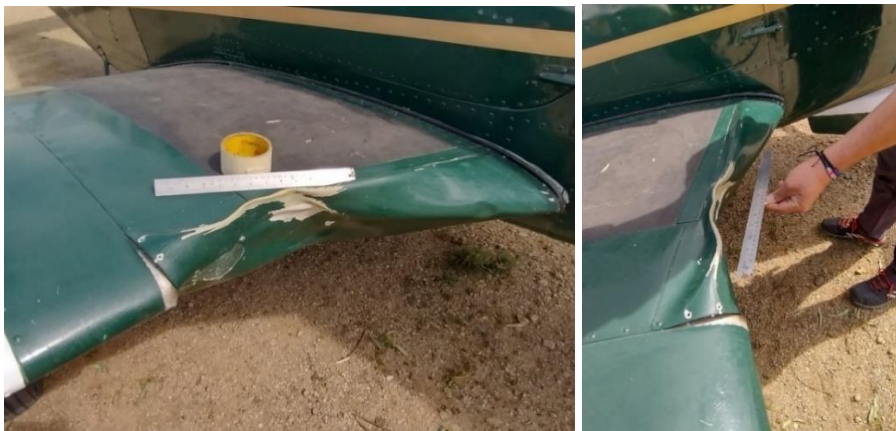
Fotografías N° 7 y 8: Daños estructurales en el recubrimiento y costillas de borde de ataque en la zona de raíz del ala derecha.
