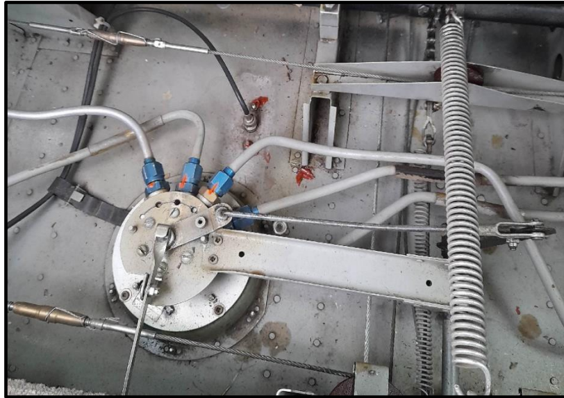
Fotografía N°11: Componente mecánico de la válvula selector de combustible
