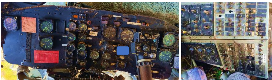
Fotografía N°27 y 28: Panel de instrumentos y circuit breaker.
