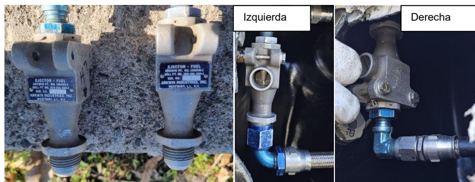
Fotografías N°34, 35 y 36: Bombas eyectoras.
