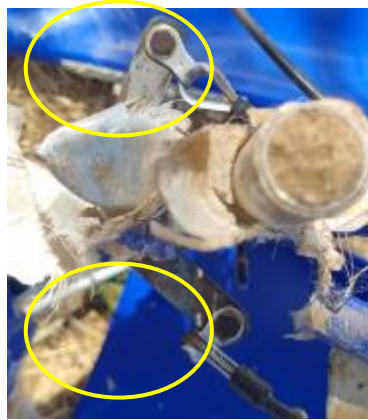
Fotografía N°19: cables del sistema de control del elevador.
