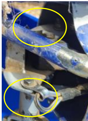
Fotografía N°18: Cables de control del timón de dirección.
