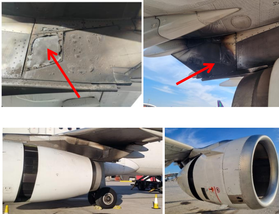
Imágenes N° 3, 4, 5 y 6: Vista de los daños en las estructuras de montaje del motor N°1 (PYLON) y parte inferior del ala izquierda.
