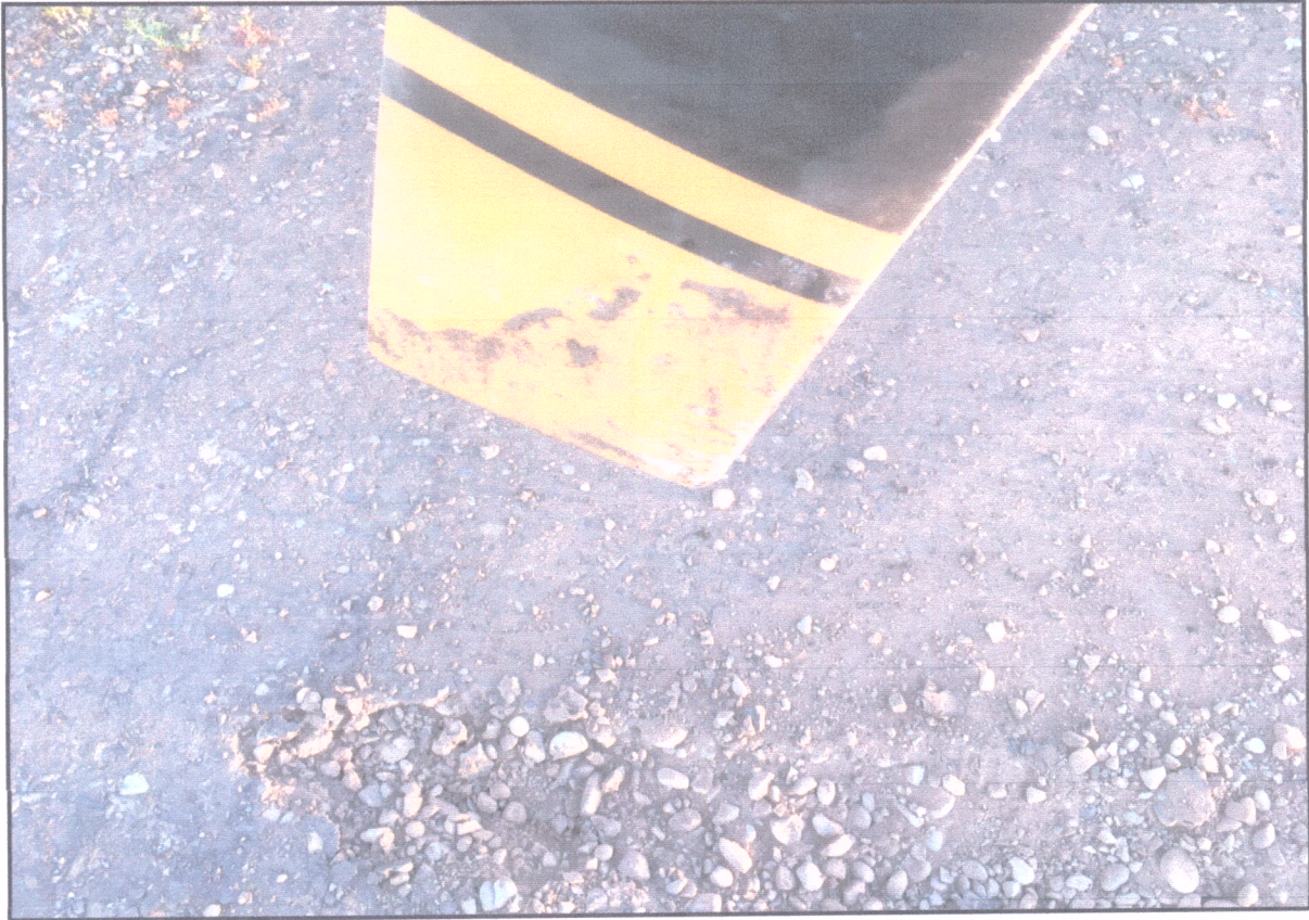
Fotografía N°2: Punta de una de las palas con evidencia de roce con el terreno.
